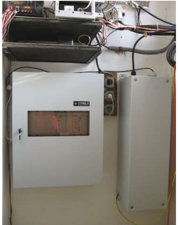
Размещение пультовой станции с блоком фильтров
